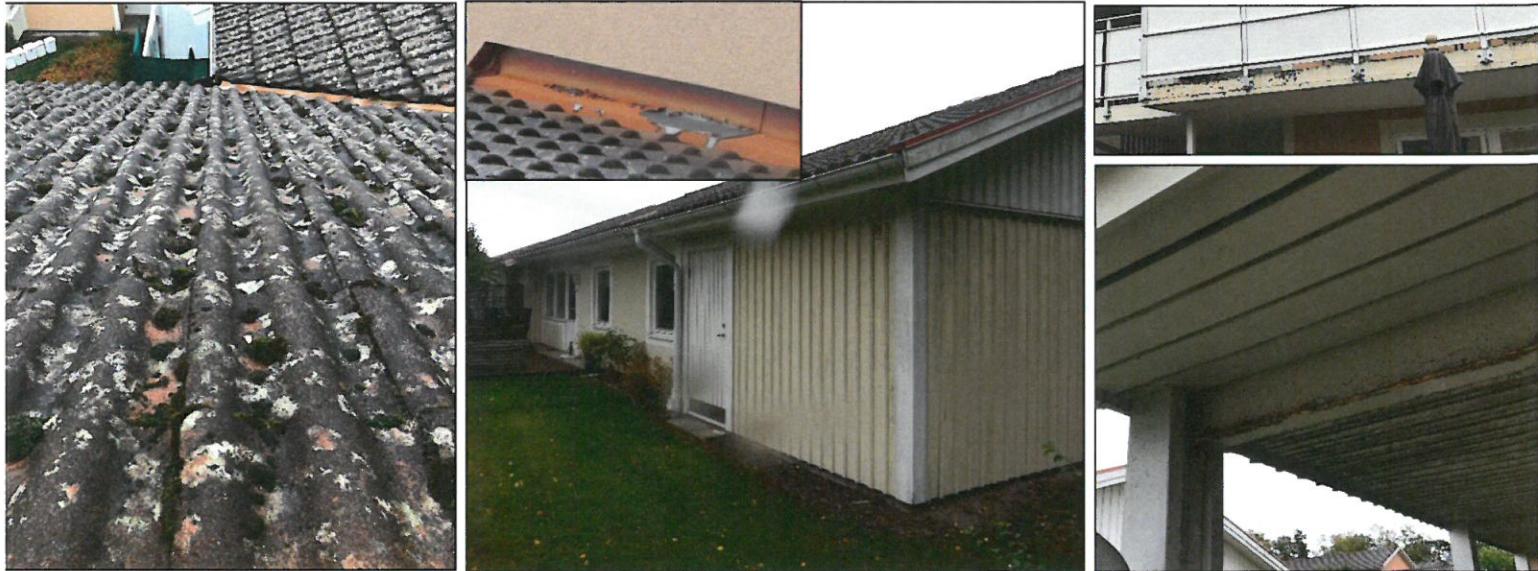
Takpannor med mossor Färgflagnig plåtdetalj / Puts- och träfasad Färgsläpp framsida balkongplatta/ Stålbalk med ytros
